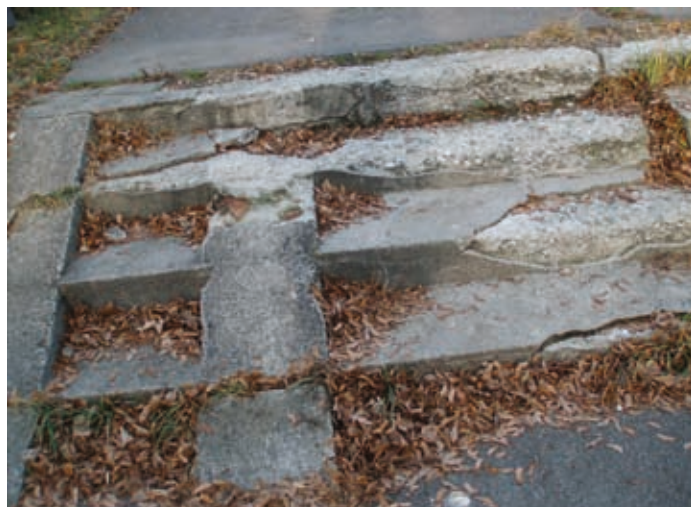
Schody se vesele rozpadají...
